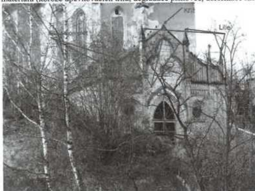
Obr. 1: Východní štít s vyznačením chybějících prvků
