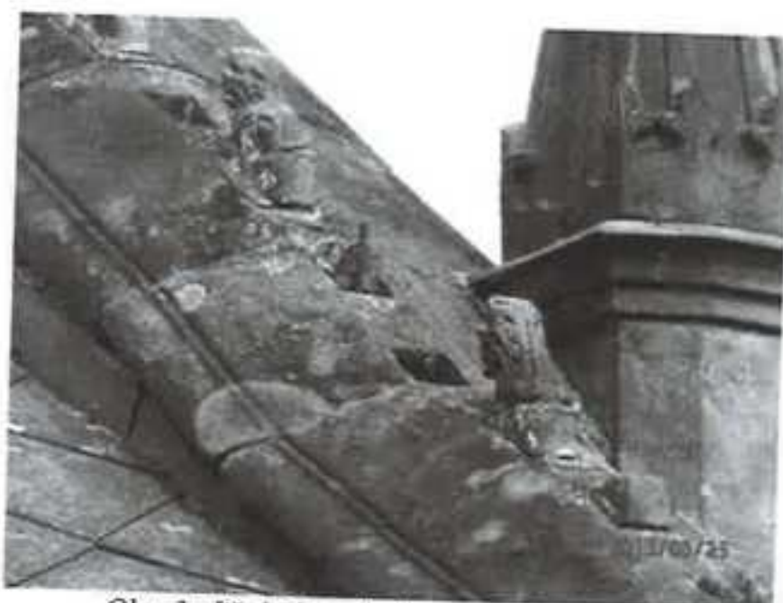
Obr. 3: Jižní část střechy – detail chybějících prvků
