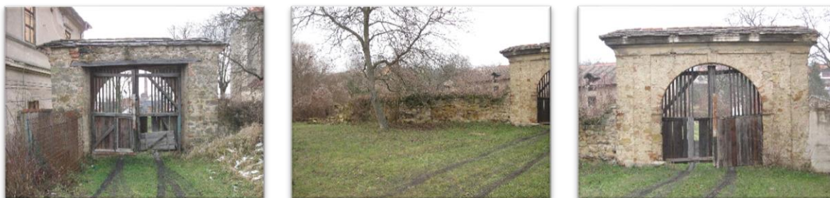
Obrázek 11: Fotodokumentace původního stavu brány a oplocení
