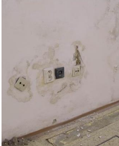
Foto 6: Vlhkostní poruchy způsobené sádrou pro fixaci elektroinstalace. (autor: L. Balík)
