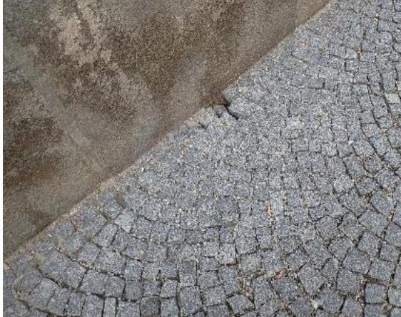
Foto č. 4: Kamenné kostky chodníku, existence prohlubně a kaverny pod ní (autor: L. Balík)
