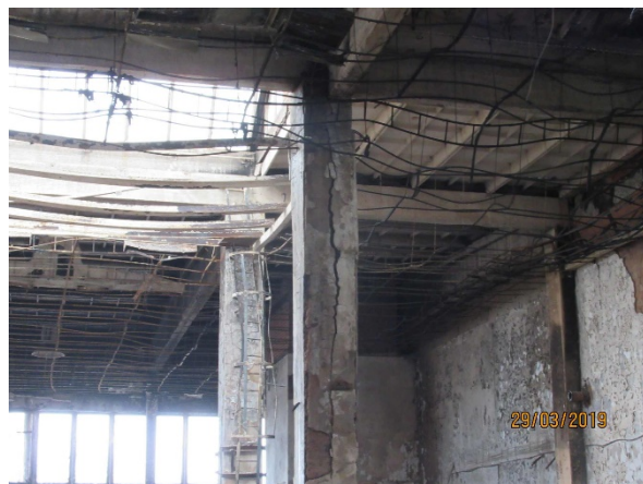
Foto č. 24: Významná trhлина ve sloupu – v tomto případě důsledek požáru (autor: I. Šimůnek)
