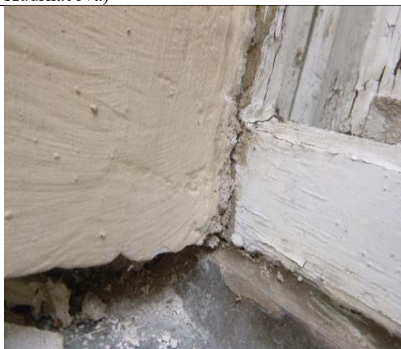
Foto č. 12: Styk několika materiálů, dřevěný rám okna, vnější ostění (autor: L. Kudrnáčová)
