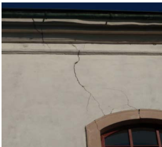
Foto č. 11: Přítomnost větších konstrukčně podmíněných trhlin (autor: L. Balík)
