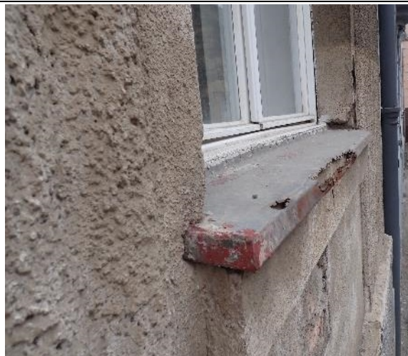
Foto č. 16: Koroze a následný rozpad klempířského prvku (autor: L. Balík)
