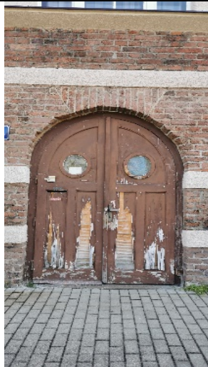
Foto č. 17: Historické vstupní dveře, plošné poškození části křídla (autor: L. Kudrnáčová)
