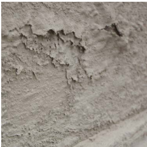
Foto č. 9: Fasáda nad soklem, poškození finálního nátěru – sprašování (autor: L. Balík)
