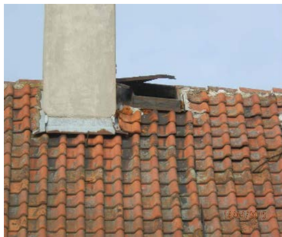
Foto č. 4: Nevhodné sanační zásahy – výplň montážní pěnou (autor: I. Šimůnek)
