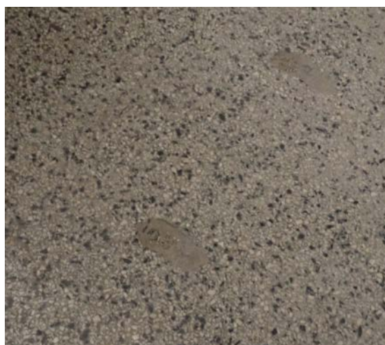
Foto č. 6: Teracová podlaha v prostoru nádražní haly, mechanické poškození (autor: L. Balík)
