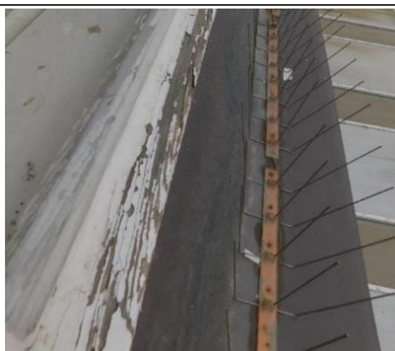
Foto č. 8: Významně degradovaná vnější okapnička (autor: L. Kudrnáčová)
