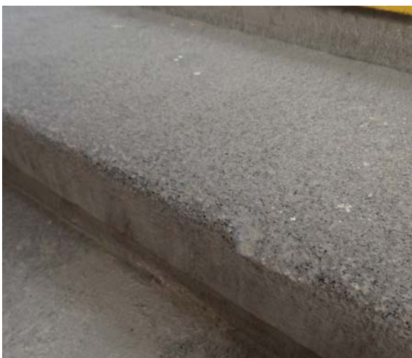
Foto č. 5: Mechanické poškození hrany stupně kamenného schodiště (autor: L. Balík)
