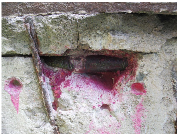
Foto č. 23: Zabarvení betonu po testu karbonatace roztokem fenolftaleinu (autor: I. Šimůnek)
