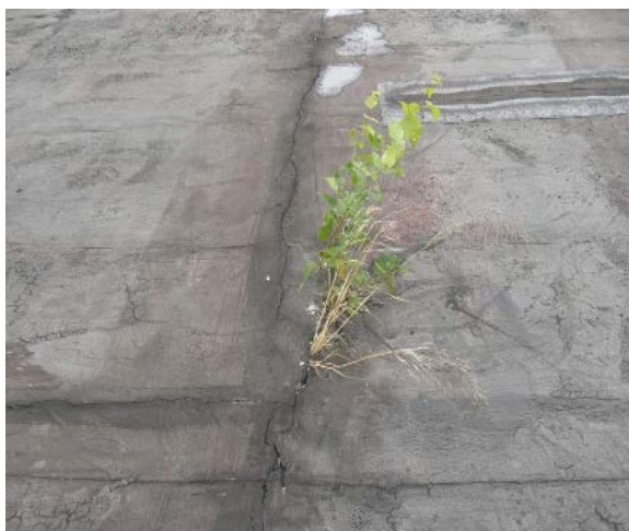
Foto č. 3: Degradace asfaltové střešní krytiny (autor: I. Šimůnek)
