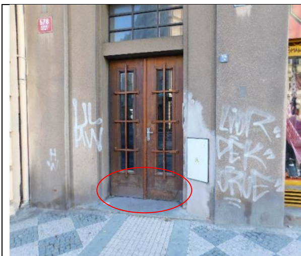
Foto č. 13: Namáhaný povrch dveří ve spodní části křídla (autor: L. Kudrnáčová)
