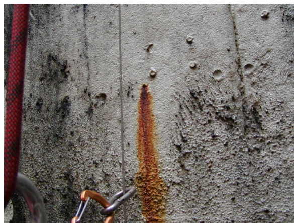
Foto č. 20: Korozní výluh na povrchu (autor: I. Šimůnek)
