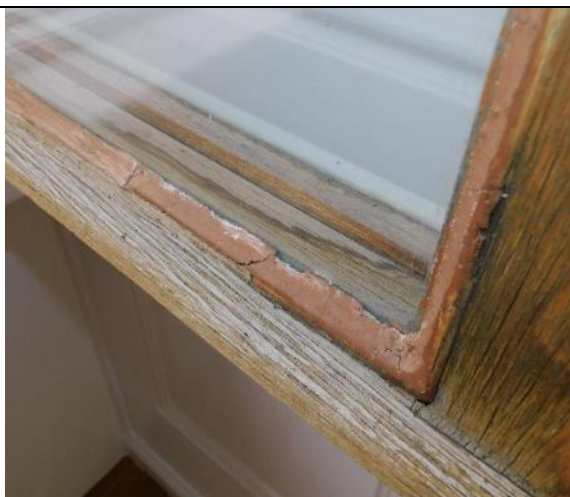
Foto č. 10: Trhlinky v povrchu tmelu zasklení, výrazně jiná barva povrchu tmelu a nátěru okna (autor: L. Kudrnáčová)
