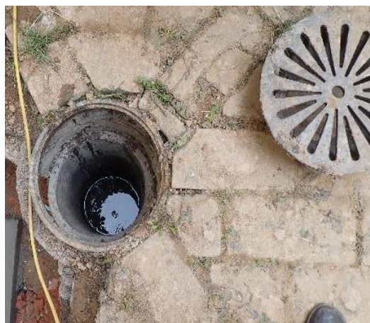
Foto č. 10: Dvorní vpusť městského činžovního domu, zadržování dešťové vody indikuje zatěsnění navazujícího ležatého kanalizačního potrubí (autor: L. Balík)
