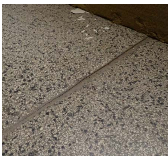
Foto č. 9: Litá teracová podlaha v chemické laboratoři, pokles nášlapné vrstvy pravého dilatačního úseku (autor: L. Balík)
