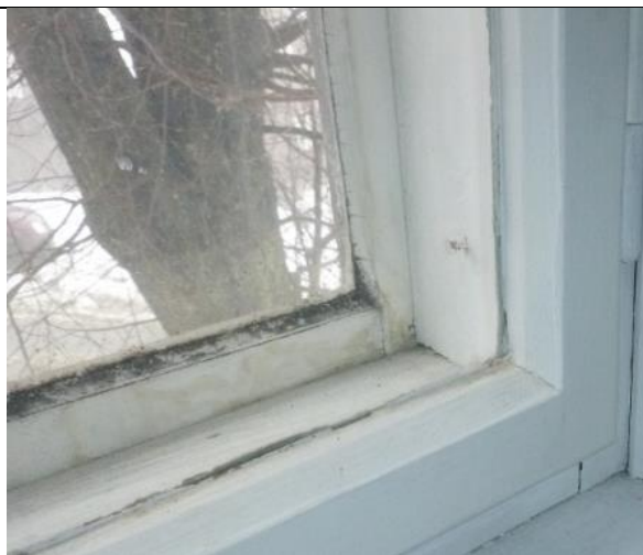
Foto č. 7: Poruchy kytování, t. těsnicího tmelu (autor: L. Kudrnáčová)
