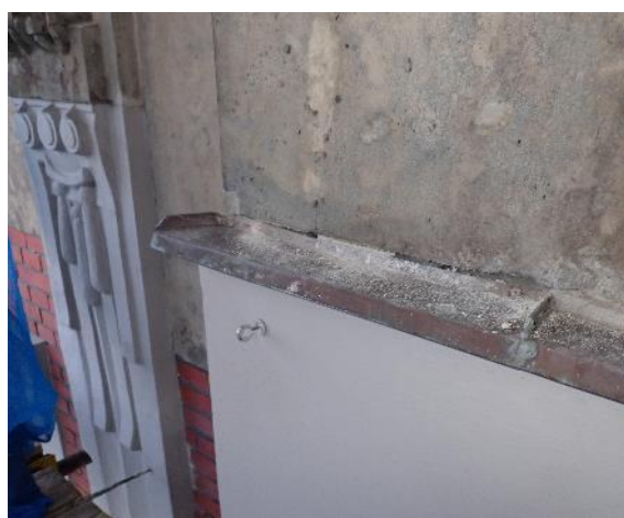
Foto č. 20: Krycí okapnice profilace fasády, tvarová deformace a opačný spád klempířského prvku (autor: L. Balík)
