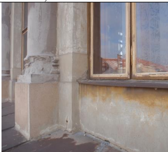
Foto č. 6: Významně degradovaný povrch okenní konstrukce (autor: L. Kudrnáčová)
