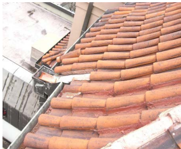
Foto č. 2: Poškození krytiny, nevhodné opravy maltou (autor: I. Šimůnek)
