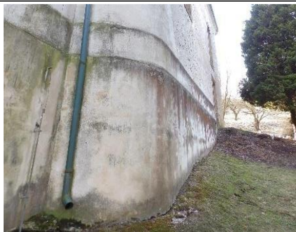
Foto č. 8: Vyústění dešťového svodu k patě soklové partie obvodové stěny kostela, trvalá přítomnost promočené zeminy pod vyústěním (autor: L. Balík)
