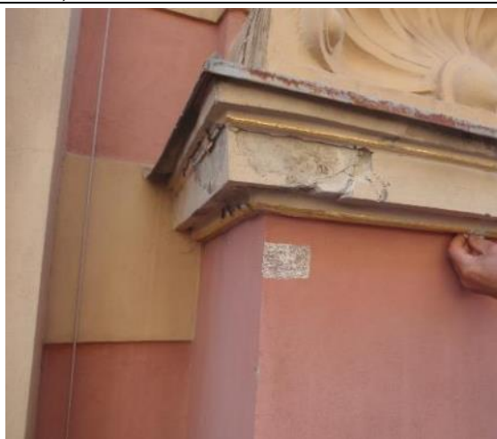
Foto č. 17: Koroze plechu krycí okapnice, destrukce štukové omítky pod okapnicí (autor: L. Balík)
