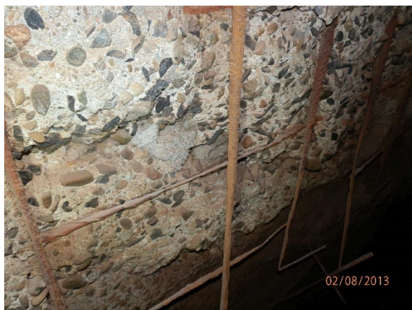
Foto č. 5: Hlubkové narušení povrchu, koroze výztuže do ztráty profilu (autor: I. Šimůnek)
