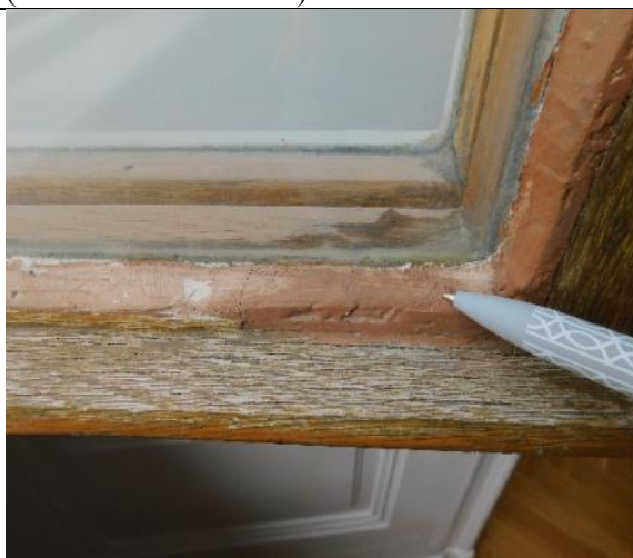
Foto č. 12: Trhlinky v tmelu zasklení křídla okna (autor: L. Kudrnáčová)
