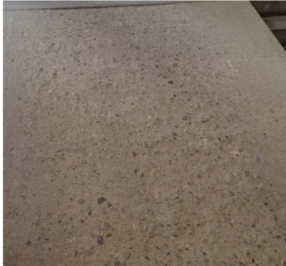
Foto č. 10: Betonová podlaha rampy v prostorách technického provozu, abraze vrchní vrstvy betonu (autor: L. Balík)
