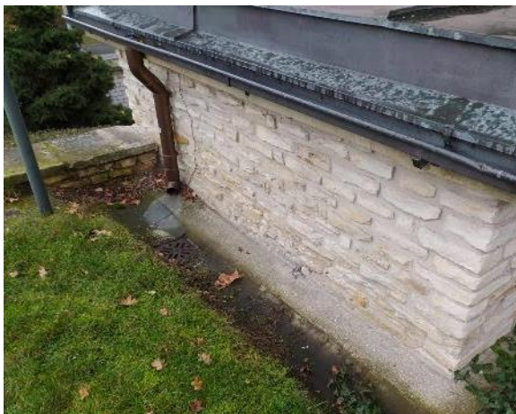
Foto č. 5: Betonový žlab podél obvodové stěny rodinné vily, vadný spád zadržuje vodu mimo vpusť (autor: L. Balík)
