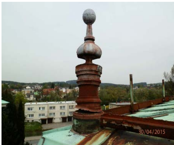
Foto č. 7: Koroze klempířských a ozdobných prvků (autor: I. Šimůnek)
