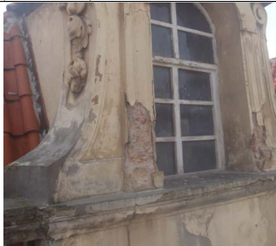
Foto č. 12: Čelní stěna vikýře, degradace a rozpad jádra omítky (autor: L. Balík)
