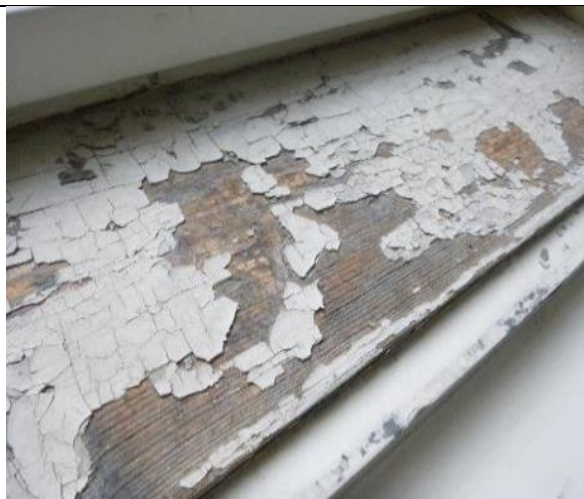
Foto č. 1: Významně porušený a chybějící nátěr v ploše dřevěné špalety (autor: L. Kudrnáčová)
