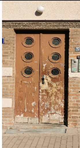
Foto č. 16: Historické vstupní dveře, plošné poškození (autor: L. Kudrnáčová)
