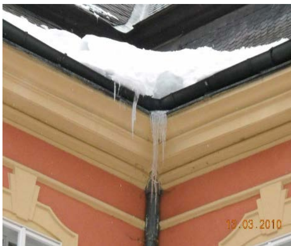
Foto č. 5: Deformace klempířských prvků tíhou sněhu (autor: I. Šimůnek)
