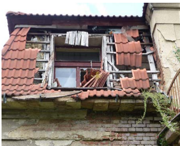
Foto č. 1: Celková absence údržby střechy (autor: I. Šimůnek)
