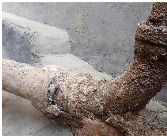
Foto č. 9: Obnažená konstrukce gajgru a navazujícího kanalizačního potrubí, porušení konstrukce ve spoji, existence výtoků dešťové vody (autor: L. Balík)
