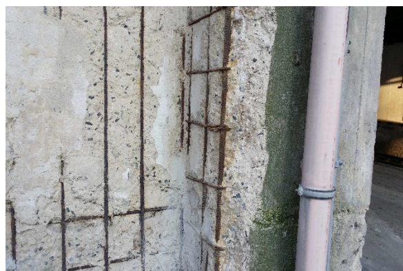
Foto č. 6: Plošné narušení povrchu a koroze výztuže, odpadnutí krycí vrstvy (autor: I. Šimůnek)
