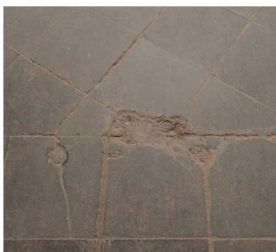
Foto č. 4: Cementová dlažba, mechanické poškození od provozu (autor: L. Balík)
