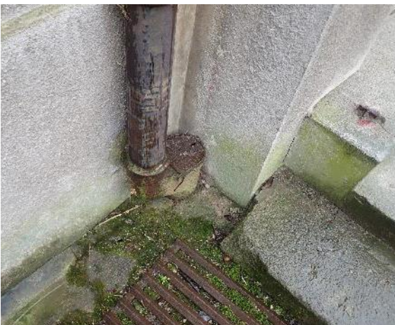
Foto č. 6: Zaústění gajgru do betonového chodníku před rodinným domem, výtoky dešťové vody indikují jeho zanesení (autor: L. Balík)
