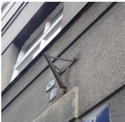
Foto č. 15: Uliční fasáda městského činžovního domu, držák žerdě vlajky, koroze oceli (autor: L. Balík)
