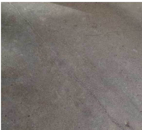
Foto č. 7: Betonová podlaha ve sklepním prostoru zkušebny, přítomnost trhliny a degradační proces betonu v jejím okolí (autor: L. Balík)
