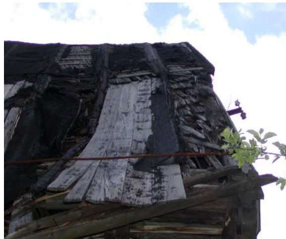
Foto č. 8: Rozpad dřevěné krytiny i konstrukce střechy (autor: I. Šimůnek)
