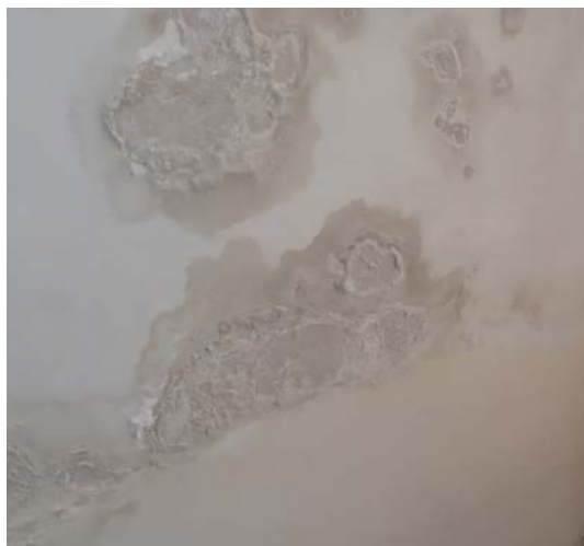
Foto č. 8: Vnitřní plocha obvodové stěny, poškození finálních vrstev vlivem krystalizace přítomných solí (autor: L. Balík)
