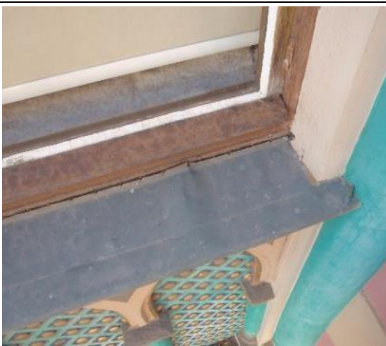
Foto č. 18: Okenní parapet, uvolnění spoje klempířského prvku s rámem okna (autor: L. Balík)
