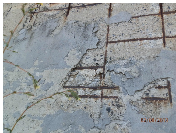
Foto č. 22: Plošné narušení povrchu a koroze výztuže, odpadnutí krycí vrstvy (autor: I. Šimůnek)
