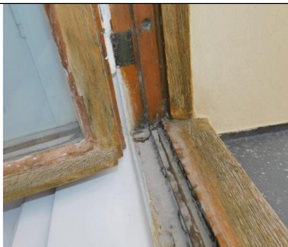
Foto č. 9: Zvýšené nečistoty ve funkční spáře okna (autor: L. Kudrnáčová)
