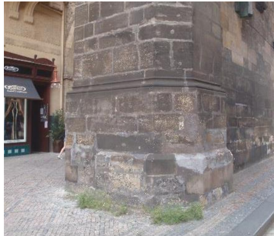
Foto č. 2: Přítomnost vegetace v těsné blízkosti paty zdiva, indikace opačného spádu a přítomnosti vody pod dlažbou (autor: L. Balík)
