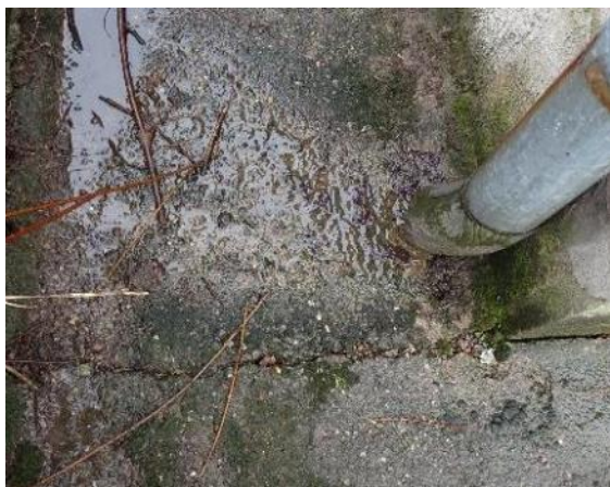
Foto č. 7: Zaústění svodného potrubí do betonového chodníku před rodinným domem, netěsnost spoje v potrubí, absence gajgru (autor: L. Balík)
