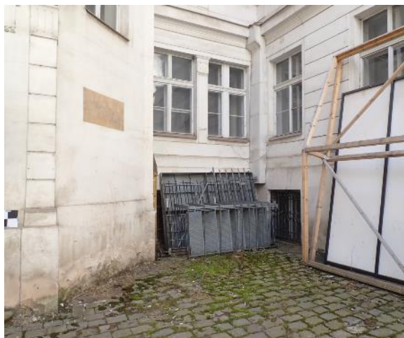
Foto č. 14: Přítomnost vegetace v oblasti prohlubně dlažby, indikace přítomnosti vody pod dlažbou (autor: L. Balík)
